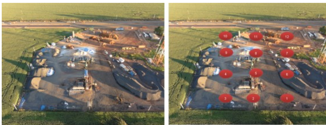
Figura 1. Fotografia aérea (a) com destaque para os pontos de coleta (b) da usina de asfalto, instalada na BR 060, km 419
